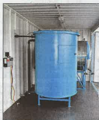
Filtertank – installiert in einem Container.
